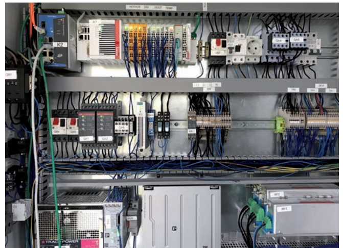
Schaltschrank mit den neuen Beckhoff-Komponenten für das RoboTel-Teleskop. Electrical cabinet with the new Beckhoff components for the RoboTel telescope.
